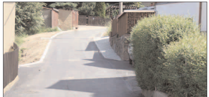
Nach dem Wechsel der TW-Leitung und dem Kanalbau erhielt die Straße Am Hang eine neue Straßendecke.
